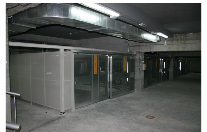
VISTA GENERAL DEL APARCAMIENTO SEMIAUTOMÁTICO
