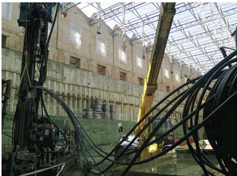
Instalación geotérmica y termoactiva. Nuevo teatro infantil en los cuarteles de David y Velarde, Madrid
